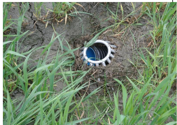
Gjenfylt inntaksrør/-kum, må utbedres. Foto: H. Grønsten.
