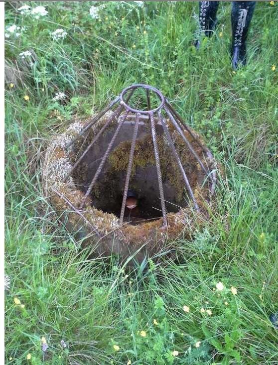
Eldre kum. Utløpet fra kum fungerer greit. Behov for mer masse rundt kummen for å hindre ytterligere graving og lede overflatevann inn kummen fra toppen. Foto: Romerike Landbruksrådgiving
