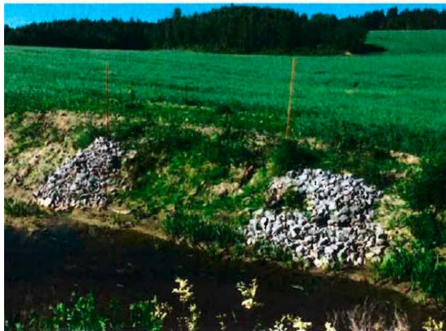
Utløp av to dreneringsutløp hvor tiltakshaver har mottatt SMIL-midler til reparasjon.
