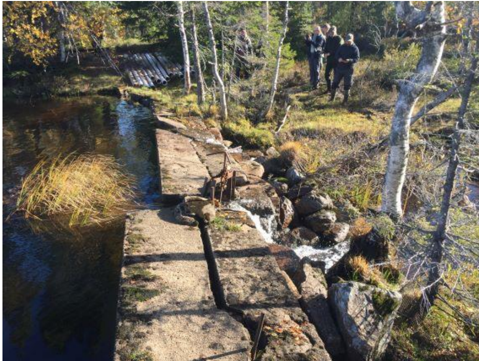
Toppen av dammen med damluke. Det er forskyvninger i fundamentet. Det har vært utført ekstra steinsetting nedstrøms, noe som antagelig holder dammen på plass.
