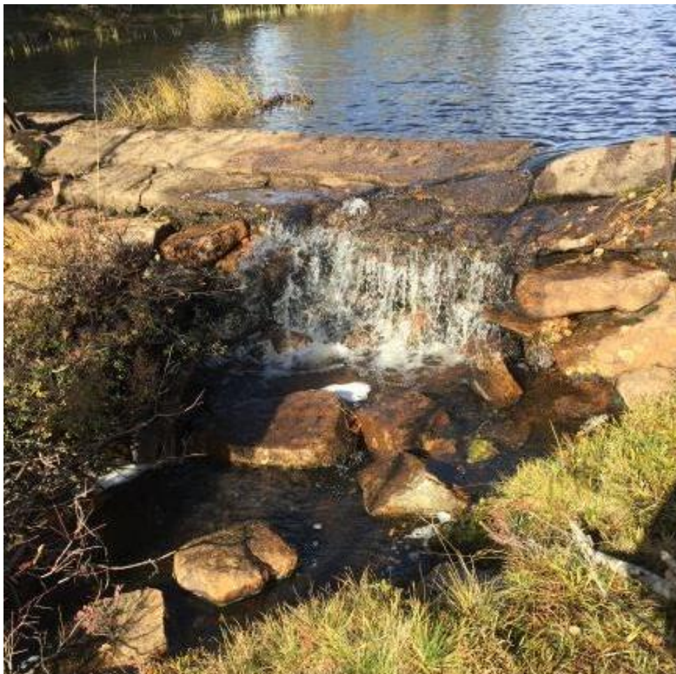
Uønsket overløp over damkrona.
