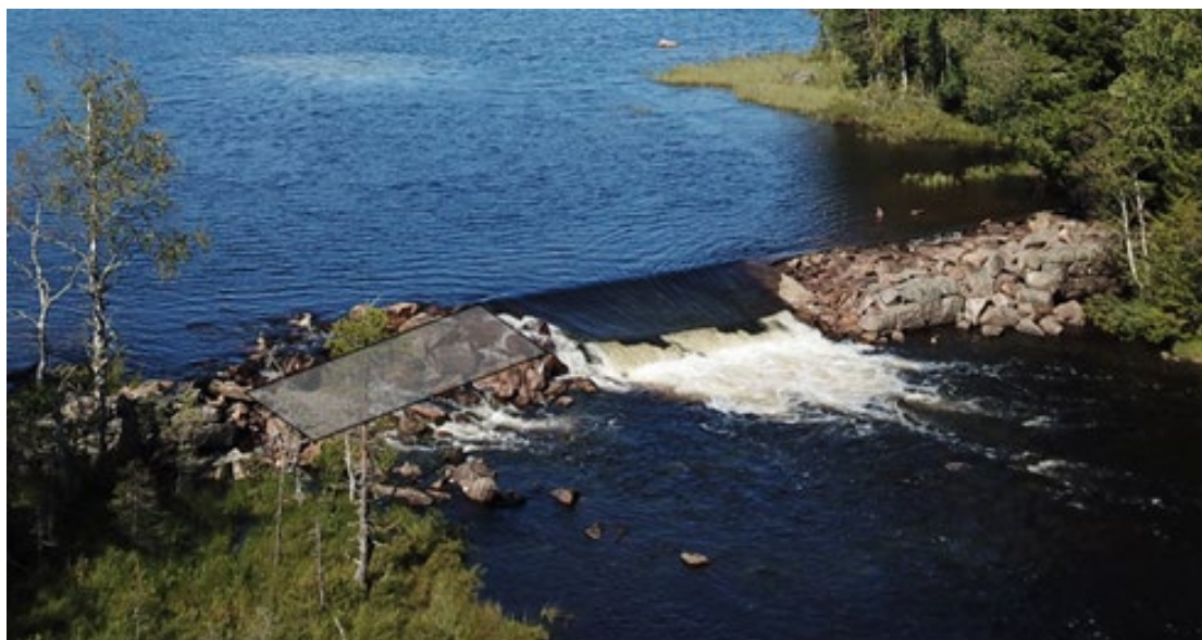
Figur 29. Illustrasjon av utraste parti, som foreslås ombygget til et nytt og bredere flomløp med større kapasitet. Foto & illustrasjon: Skred AS v/Lars Staver Eid
