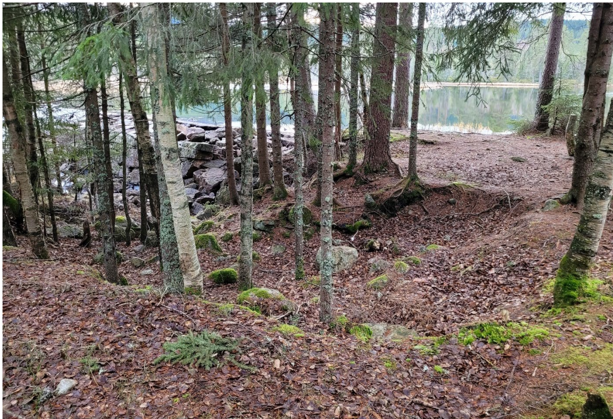
Figur 13. Erosjonssår på nordsiden av demningen ved Stråtjern, november 2024. Foto: NRAS, Odin Kirkemoen.
