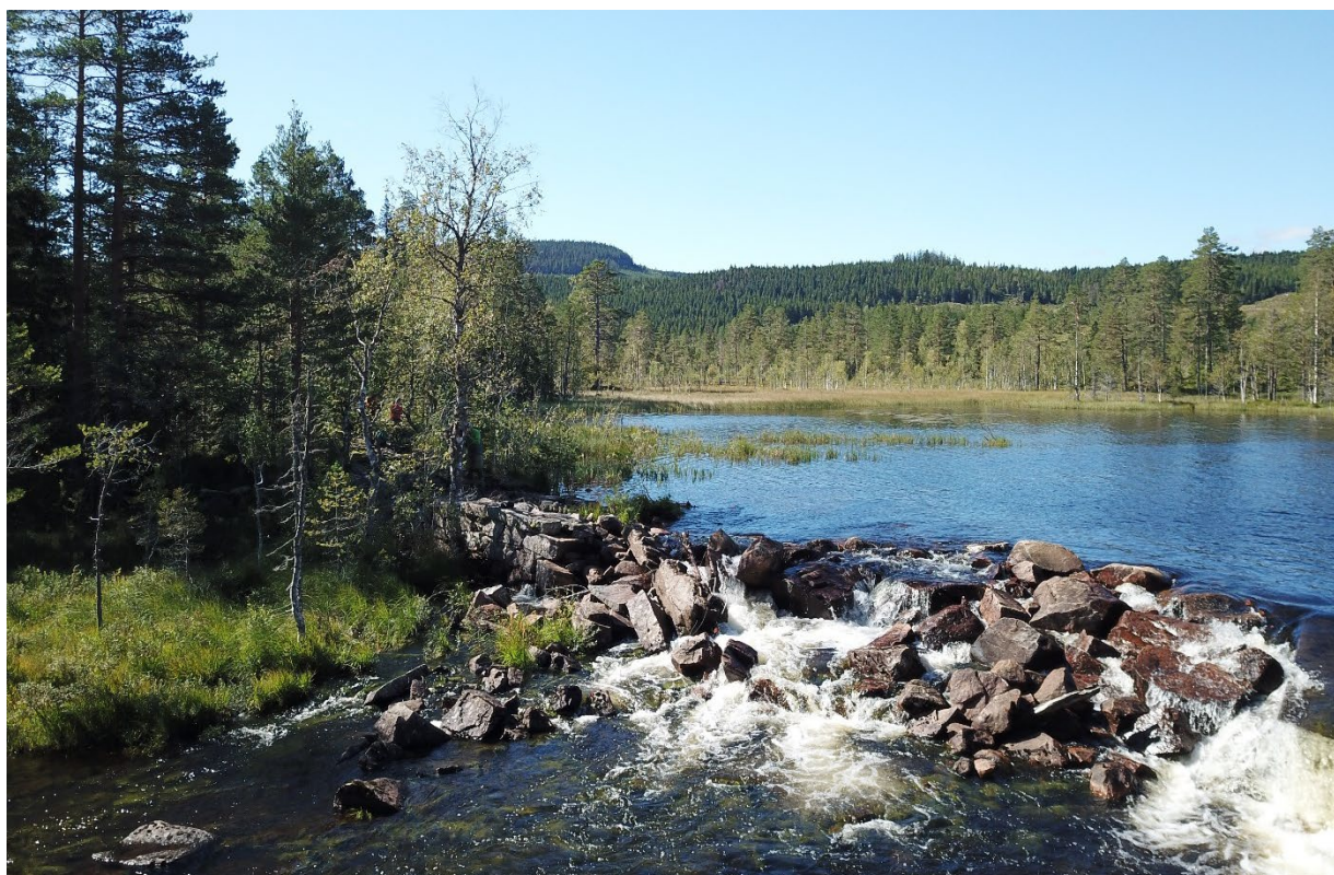
Figur 12. Stråtjerndammen, august 2024. Skade på sørsiden av demningen. Foto: Skred AS, Lars Staver Eid.
