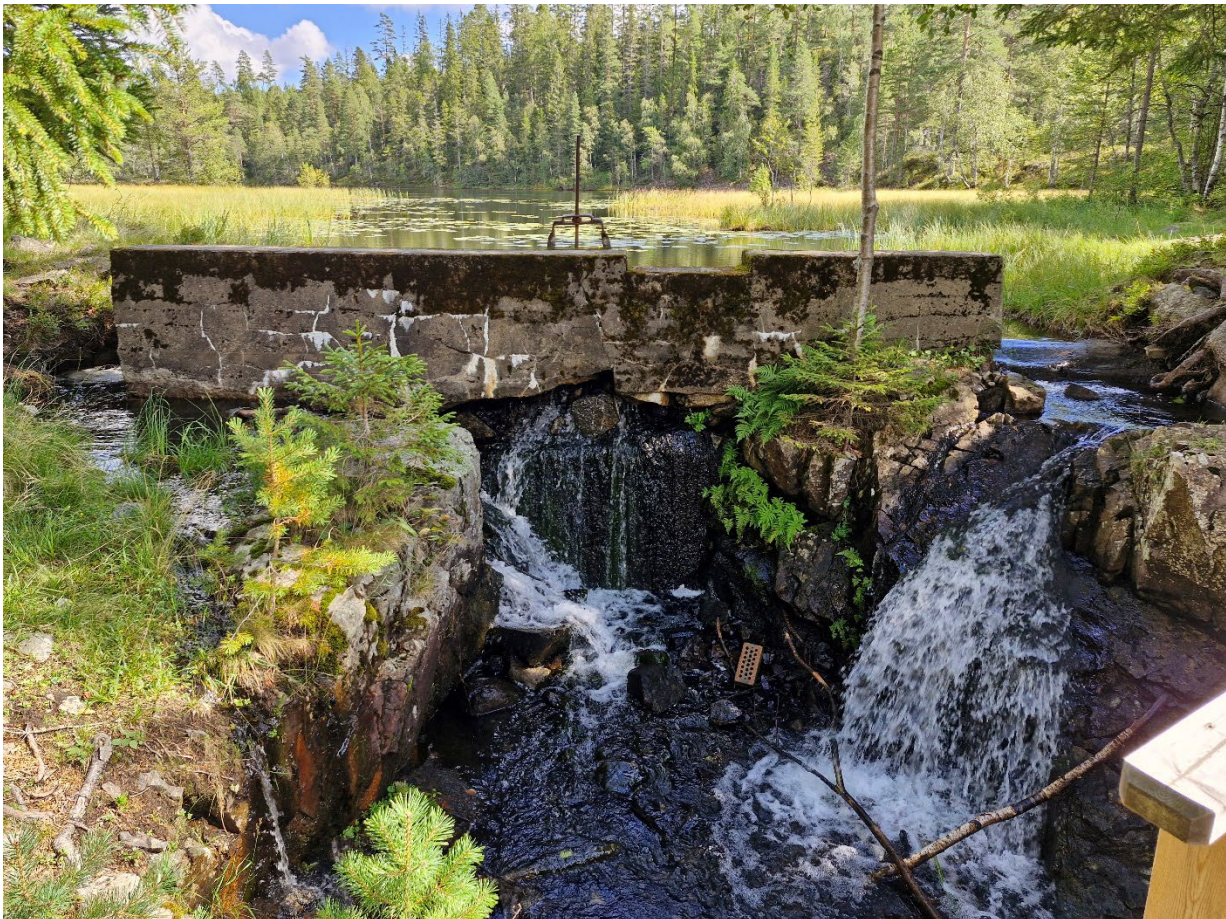
Figur 15. Dam ved utløp av Djupøyungen, august 2024. Dammen lekker på begge sider og under den øverste påstøpen. Øvre del av dammen har inskripsjonen «1957». Foto: Skred AS, Lars Staver Eid.
