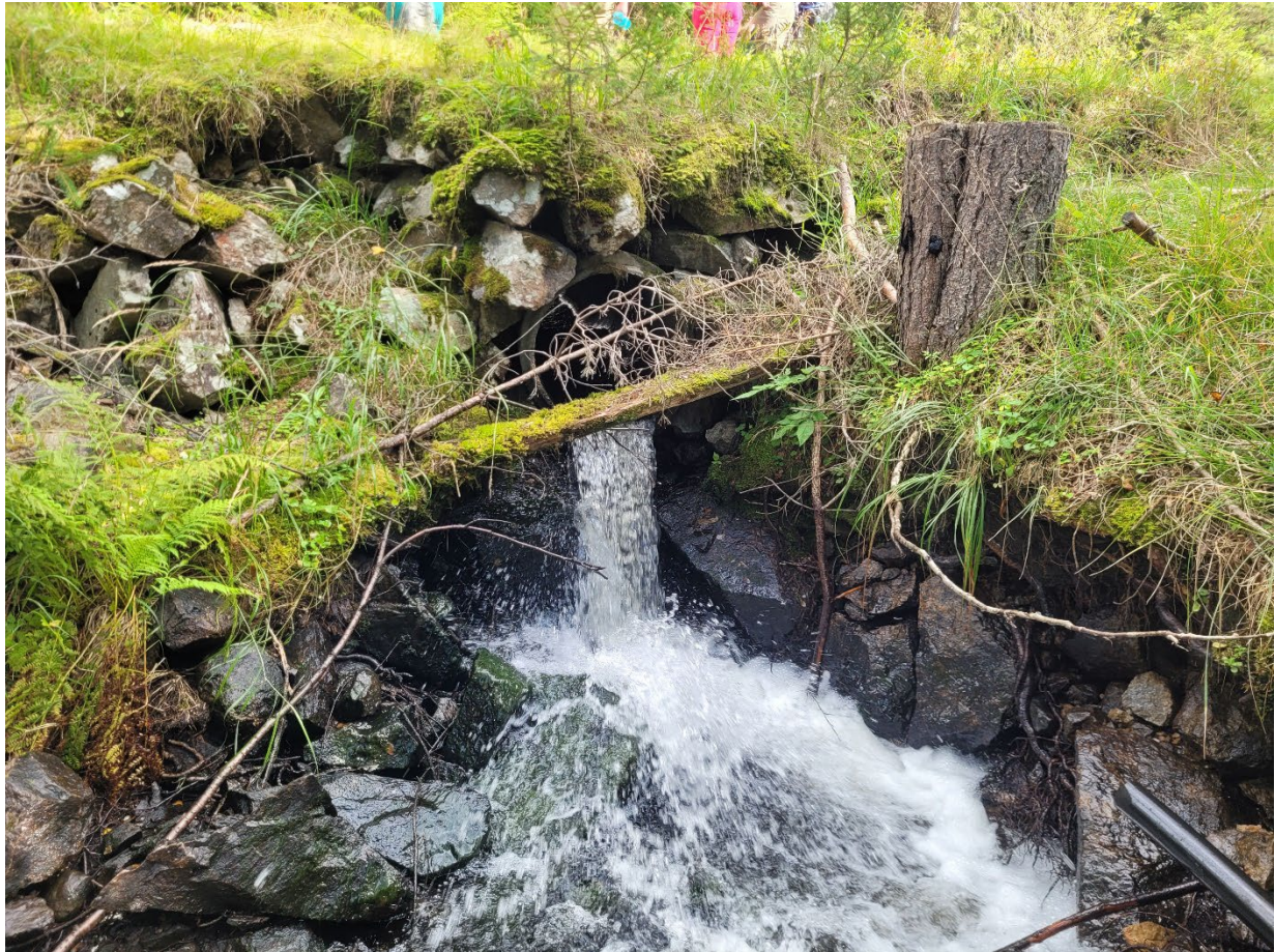
Figur 19. Veikulvert med vertikalt fall ved utløp, august 2024. Kulverten har også helling, slik at vannhastigheten er høy. Kulverten er isolert sett en fullstendig vandringsbarriere for ørret på oppstrøms vandring. Foto: NRAS, Odin Kirkemoen.
