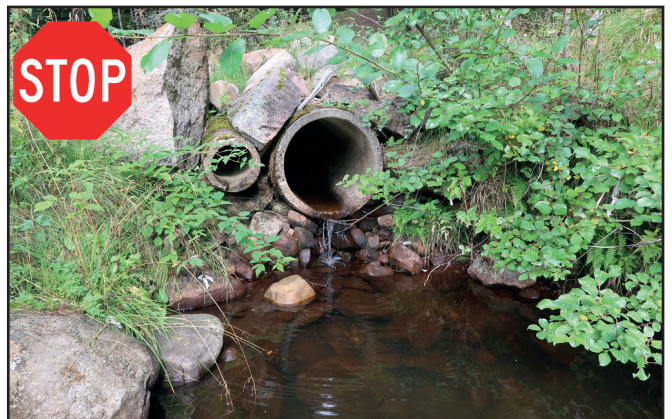
Bilde 2: Legges rørene slik, skapes unødvendig stengsel for oppvandrende gytefisk. Bildet viser en gytebekk som er sterkt forringet fordi røret er lagt feil.
